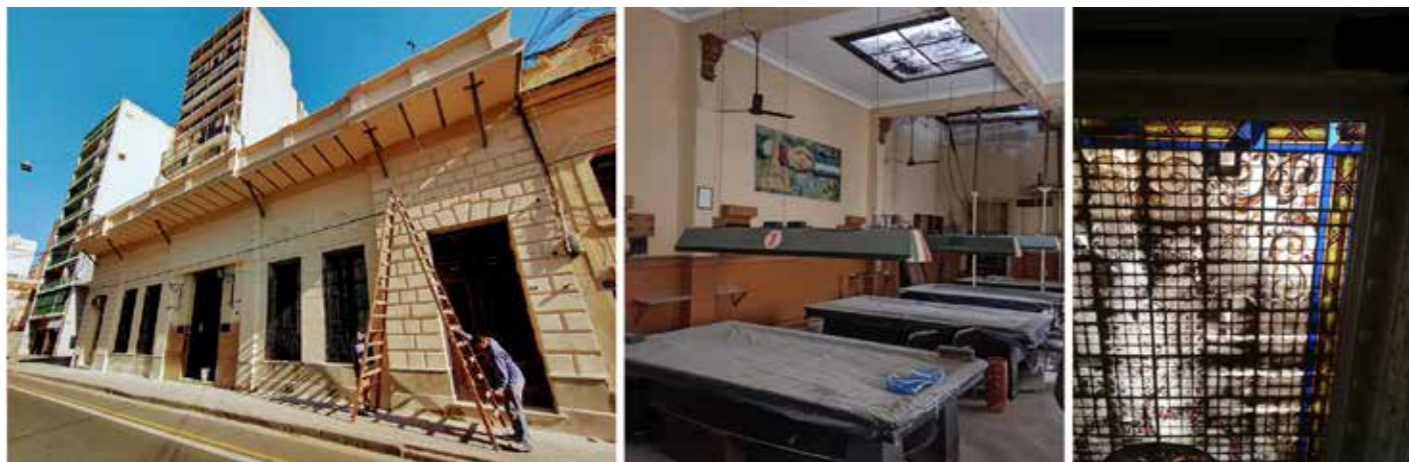
Fig. 1 - De izquierda a derecha: obras de renovación de la fachada, hundimiento del forjado en la sala de billar y claraboya en el pasillo principal.
