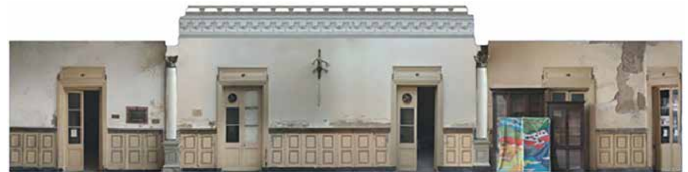
Fig. 3 - Ortofoto longitudinal de la nave central que muestra algunos fenómenos de degradación.
